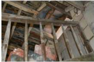
Photo 1 Mauvais état général des charpentes
